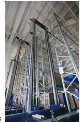
パレット自動倉庫
