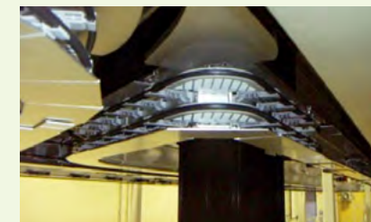
断面の大きい給電線を採用
