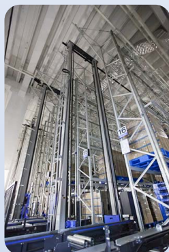
パレット自動倉庫
